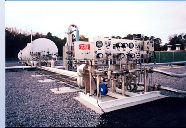
LNG Truck Loading
